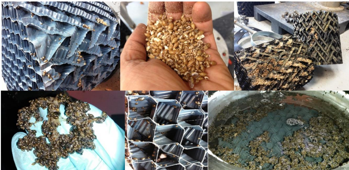
Abbildung 46 Befall des Festbettes mit Schnecken. Nach Abstellen des Zulaufes über Tage sammeln sich die Schnecken aufgrund des Sauerstoffmangels an der Oberfläche und können entnommen werden. Diese Massnahme hat jedoch nur vorübergehenden Erfolg. Nach Ausbau der Wabenpackungselemente wurde kein Biofilm vorgefunden, jedoch massenhaft Schneckenhäuser.
