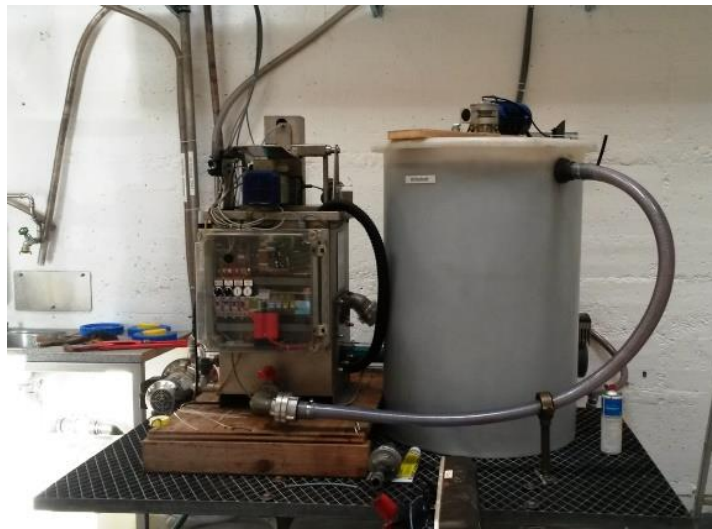
Abbildung 27 Wirbelbett-Reaktor mit nachgeschalteter Tuchfiltration (Minifilter) der Firma Mecana Umweltechnik AG.
