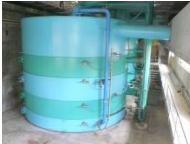
Abbildung 18 Sandfilter der ARA Neugut in der Filtrationshalle. Die Sandfilteranlage der ARA Neugut besteht aus zwei Filtern mit je zwei Kammern, welche über einen Quelltopf beschickt werden. Bei Rückspülungen kann der Zulauf nur über einen Filter geleitet werden. Über Schieber kann der Ablauf der Nachklärung auch direkt auf die Filter geleitet werden bzw. können für Revisionen auch die Filter umfahren werden.
